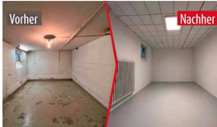
Vorher und nachher: Jeder Keller kann noch gerettet und der weitere Feuchteintritt unterbunden werden.
