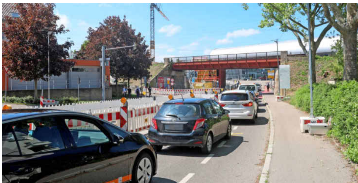
Die Baustelle für die neue Eisenbahnbrücke sorgt in der Felix-Wankel-Straße in Neckarsulm für Stau. Nach anfänglichen Problemen mit der Ampelschaltung wurde nun laut Stadtverwaltung nachgebessert.
