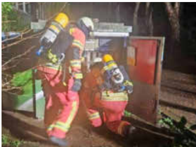
In Weinsberg hat es in einer Trafostation gebrannt.
