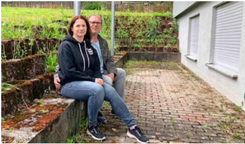
Nachdem das Wasser einen Teil der Hecke auf der Gartengrenze zerstört hat, reichte der Wasserspiegel bis knapp unter die Fenstersimse im Untergeschoss. Foto: Götz Greiner
