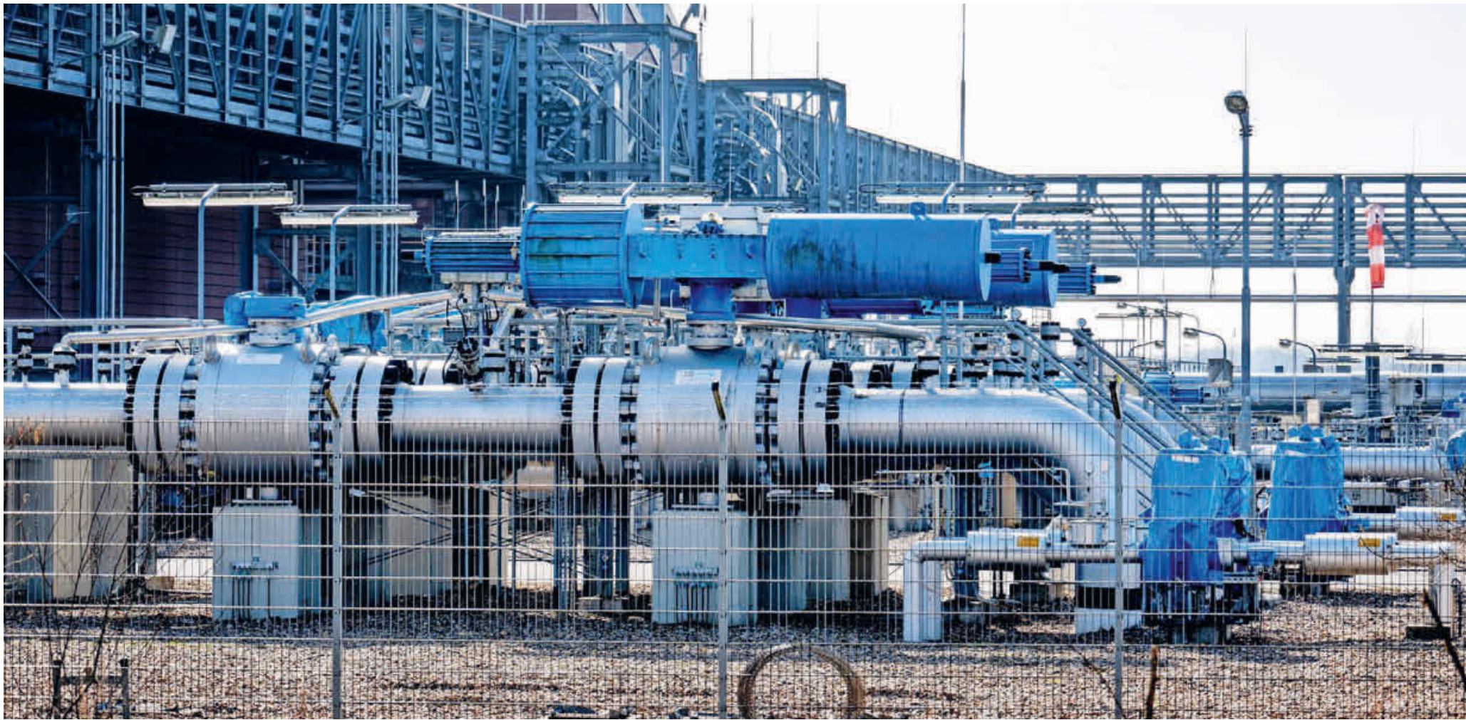
Eine Art der Vorratshaltung: Technische Anlagen zur Speicherung von Erdgas in unterirdischen Kavernen auf dem Gelände einer Speicherstation in Niedersachsen.
