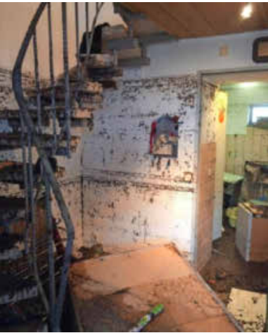
Die gesamte untere Etage des Wohnhauses stand unter Wasser.
