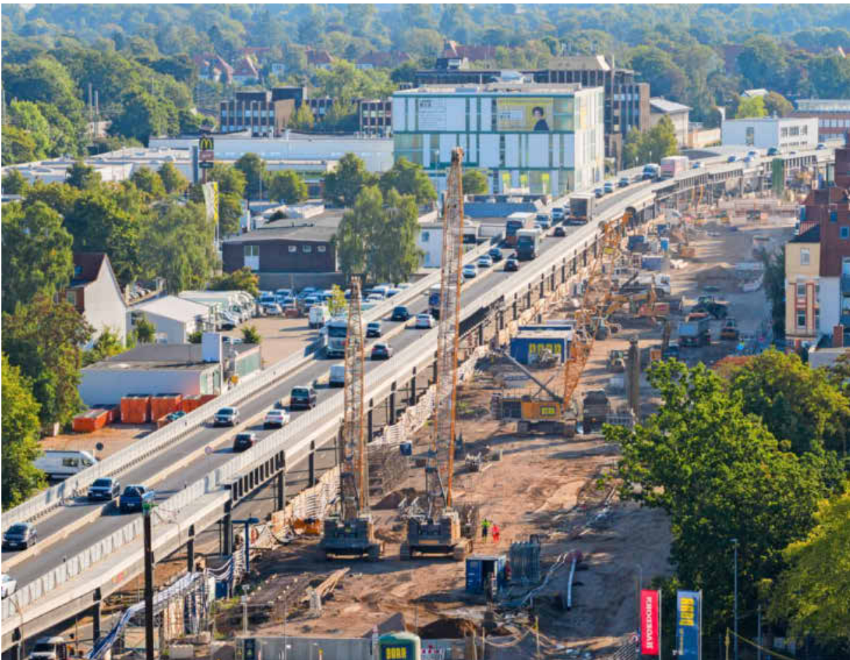
Mit dem Sondervermögen sollen unter anderem marode Brücken in ganz Deutschland wieder auf Vordermann gebracht werden. Hier werden zumindest Fortschritte vermeldet, aber es gibt noch viel zu tun. Foto: dpa
